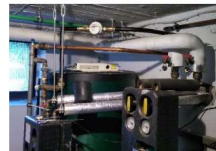
Abbildung 1: So sieht's im Keller aus.
